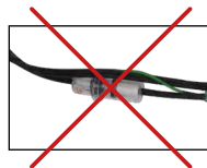
冷凝水槽 错误
